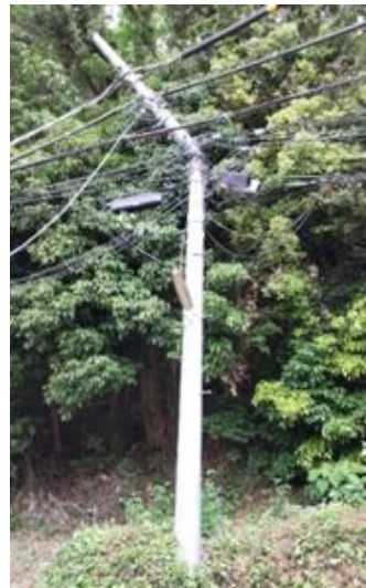
修復前の状況
